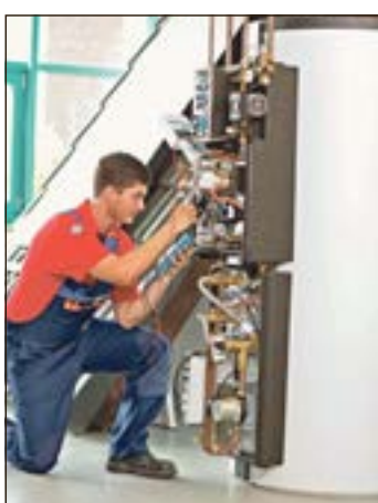
Die Sanitär- und Heizungsinstallation verlangt technisches Verständnis. Foto: djd/ZVSHK
