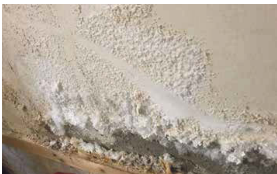
Beispielhaftes Schadensbild mit Ausblühungen
