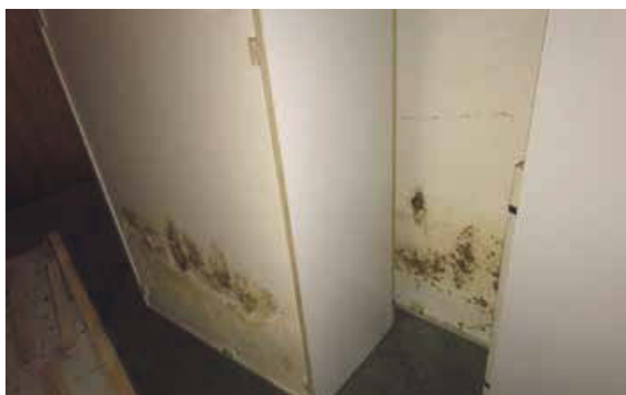
Beispielhaftes Schadensbild mit Schimmelbefall
